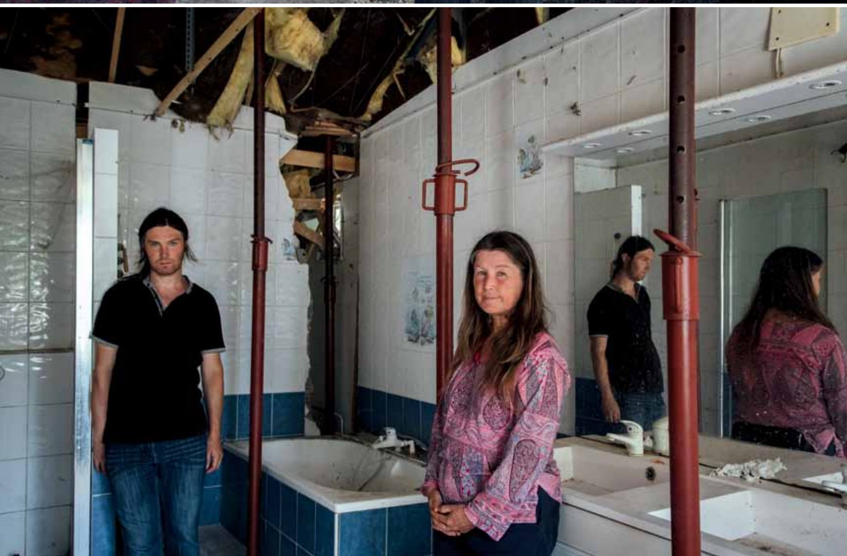
Sécheresse dans le Marais poitevin. Les fissures de la maison de Pascale et de son fils Joffrey, achetée en 2013 à Saint-Jean-de-Liversay, l'ont rendue inhabitable. Coût de la remise en état : 230 000 euros.
